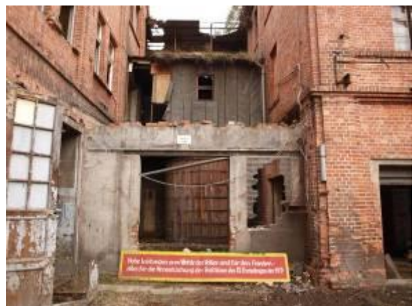
Gebäude zum Abbruch bestimmt (Einsturzgefahr)
