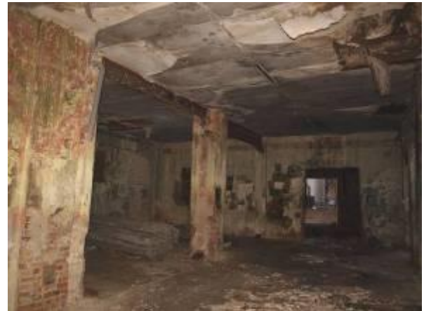
Innenraumkontrolle auf Gebäudebrüter und Fledermäuse (einsturzgefährdete Decken)
