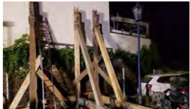
Abstützmaßnahmen eines unterspülten Hauses
